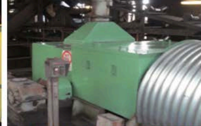
PRESIDIO SU TRAMOGGIA
