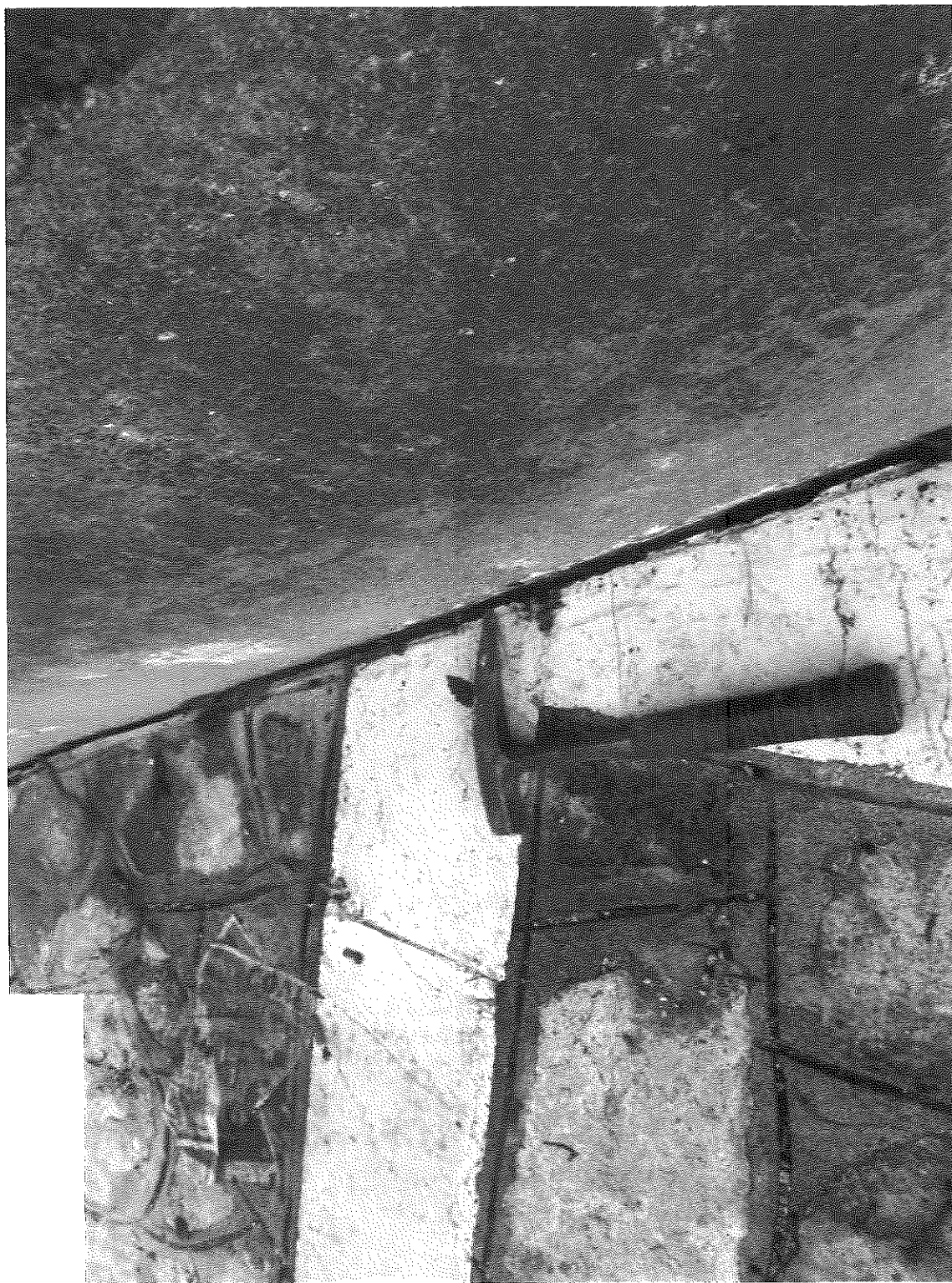
Figura 16 – Distacco della pavimentazione di nuova realizzazione dal muro di sostegno (versante meridionale).
