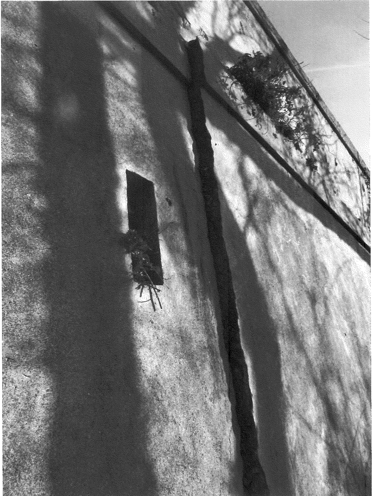
Figura 15 – Spostamento di circa 10 – 15 cm verso valle del muro di sostegno a seguito del sisma (versante meridionale).
