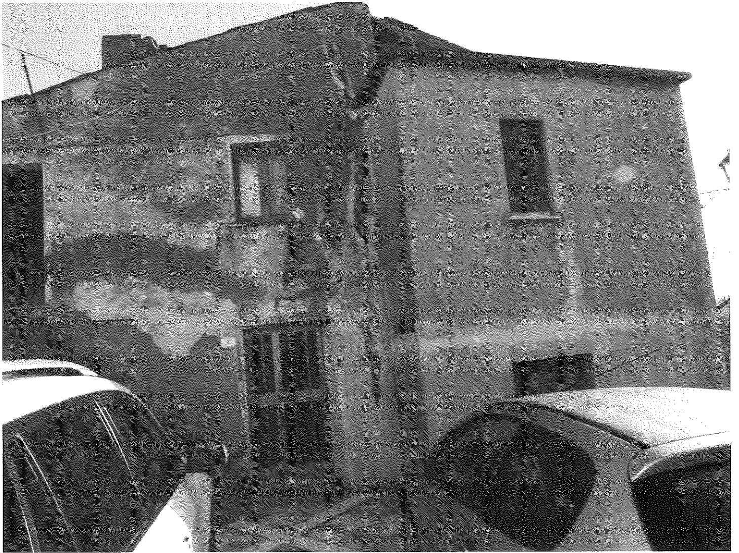
Figura 22 - Danni alle strutture a seguito sisma e delle problematiche geomorfologiche .
