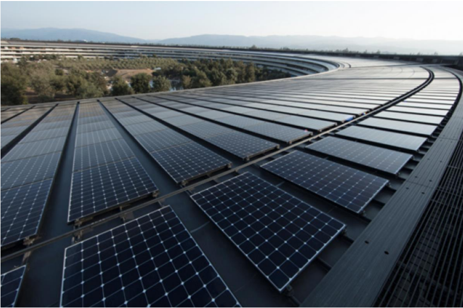
Figura 16. Il centro direzionale della Apple a Cupertino (California) è alimentato totalmente da energie rinnovabili provenienti, in parte, dal fotovoltaico installato sul tetto che fornisce 17 MW.
