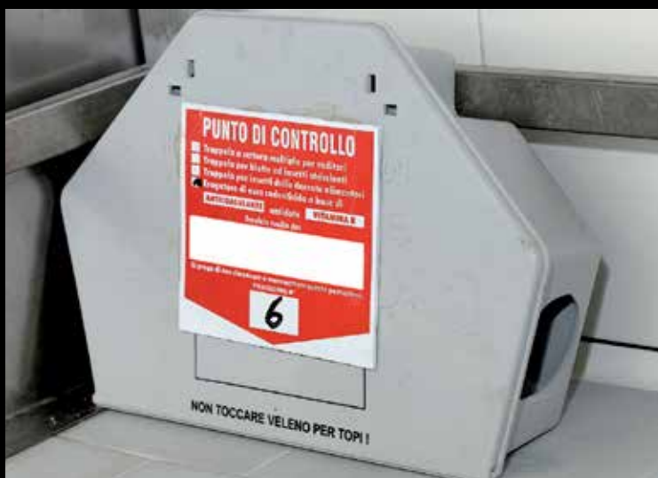
46. Corretta attività di derattizzazione con l'impiego di cassetta contenente veleno per topi
