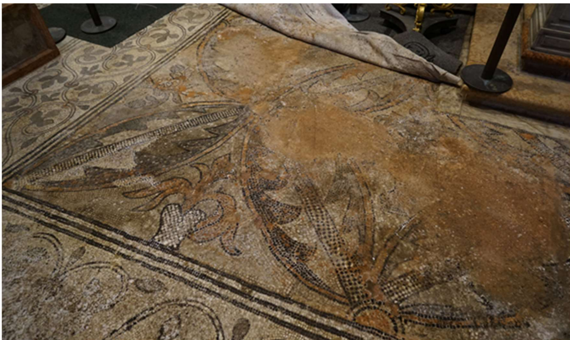
Figura 15 – I danni provocati dall'acqua alta su un tratto della pavimentazione musiva dell'altare del Santissimo.
