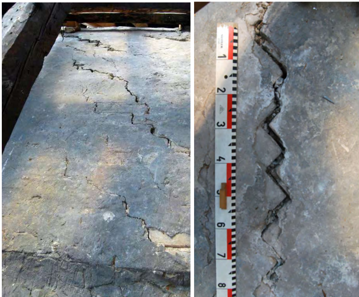
Figure 4, 5 – Alcune delle lesioni presenti sull'estradosso della volta a botte
