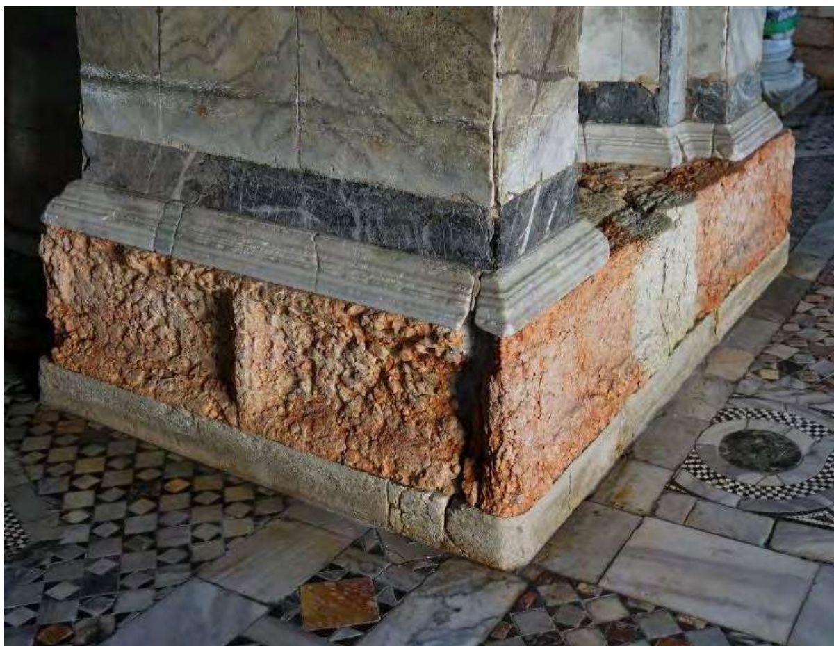
Figura 4 – Il degrado del materiale lapideo (Rosso ammonitico veronese) della base di un pilastro.
