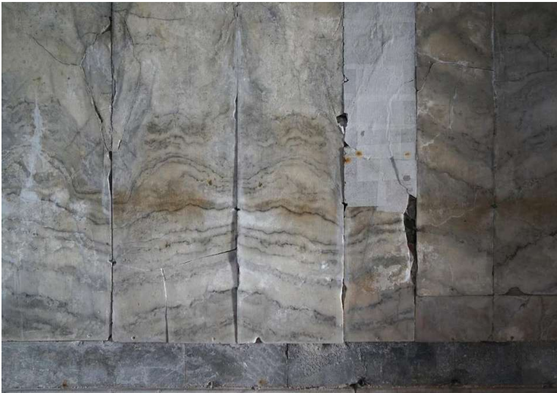
Figura 11 – Narcece. L'accentuato degrado delle lastre marmoree di rivestimento.
