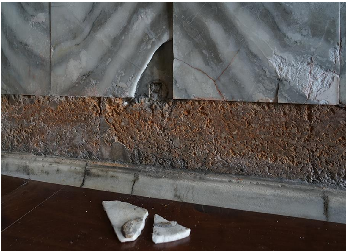
Figura 25 – Il degrado delle lastre marmoree e frammenti caduti.
