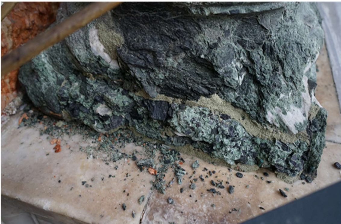
Figura 7 – Prospetto ovest. La disgregazione di una base di colonna di Verde Antico.
