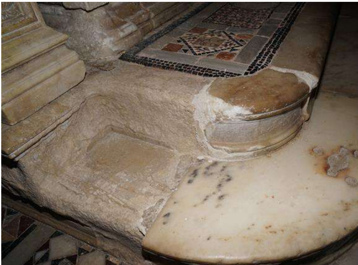
Figura 5 – Le condizioni conservative di alcuni gradini.
