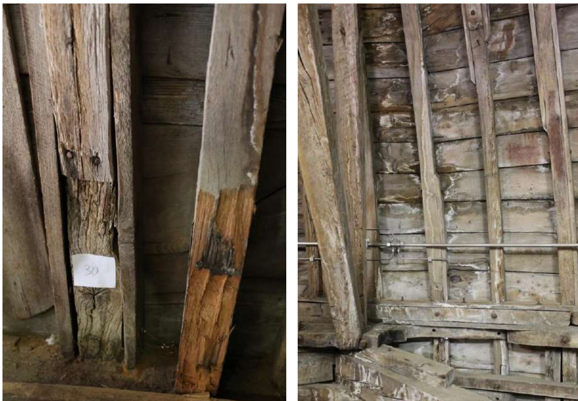
Figure 2, 3 – Lo stato di degrado delle costolature e del tavolato di sottomanto.
