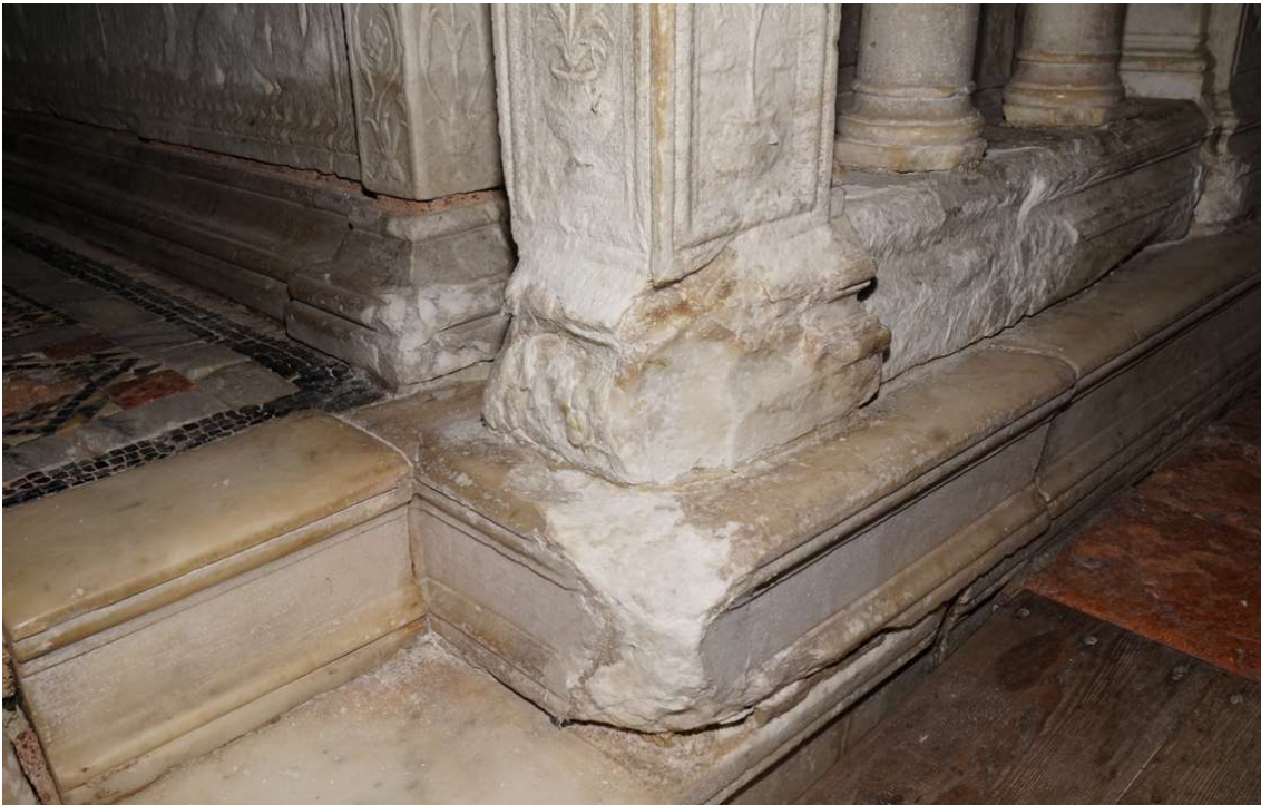
Figura 9 – Interno della Basilica. Lo stato di degrado dell'altare rinascimentale di San Paolo
