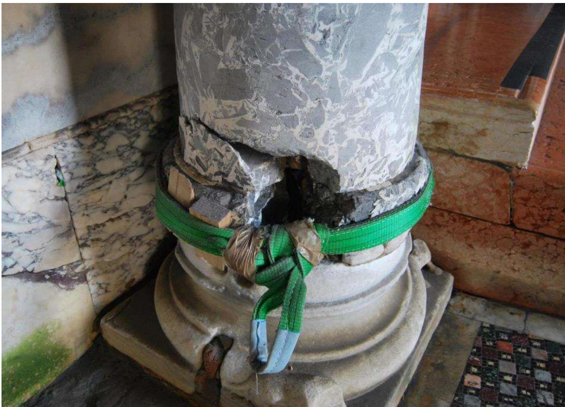
Figura 20 – Nartece. Le gravissime condizioni di dissesto di una colonna del nartece, provocate dall'ossidazione dei perni metallici causata delle continue bagnature delle acque alte .
