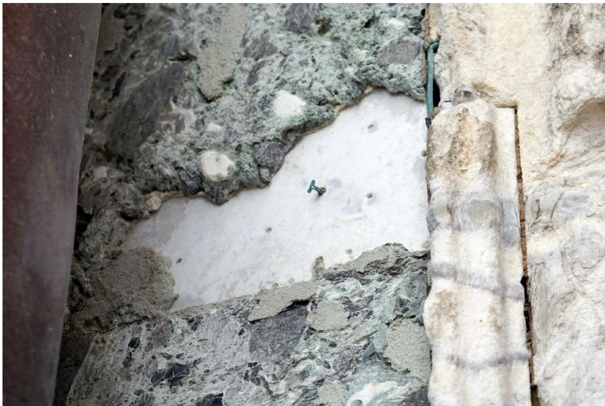
Figura 7 – Caduta di una sottile lastra di rivestimento di Marmo Verde Antico.
