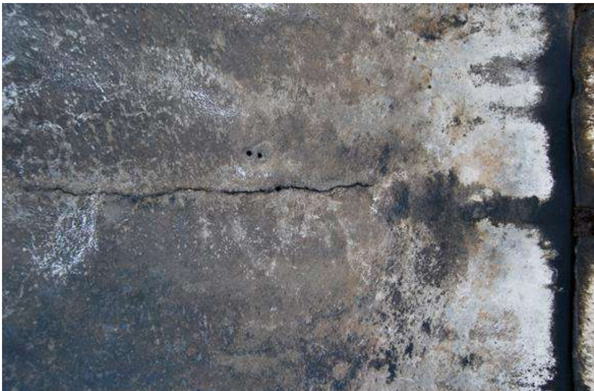
Figura 6 – Mappatura dello stato di degrado di due spicchi delle costolature e del tavolato.
