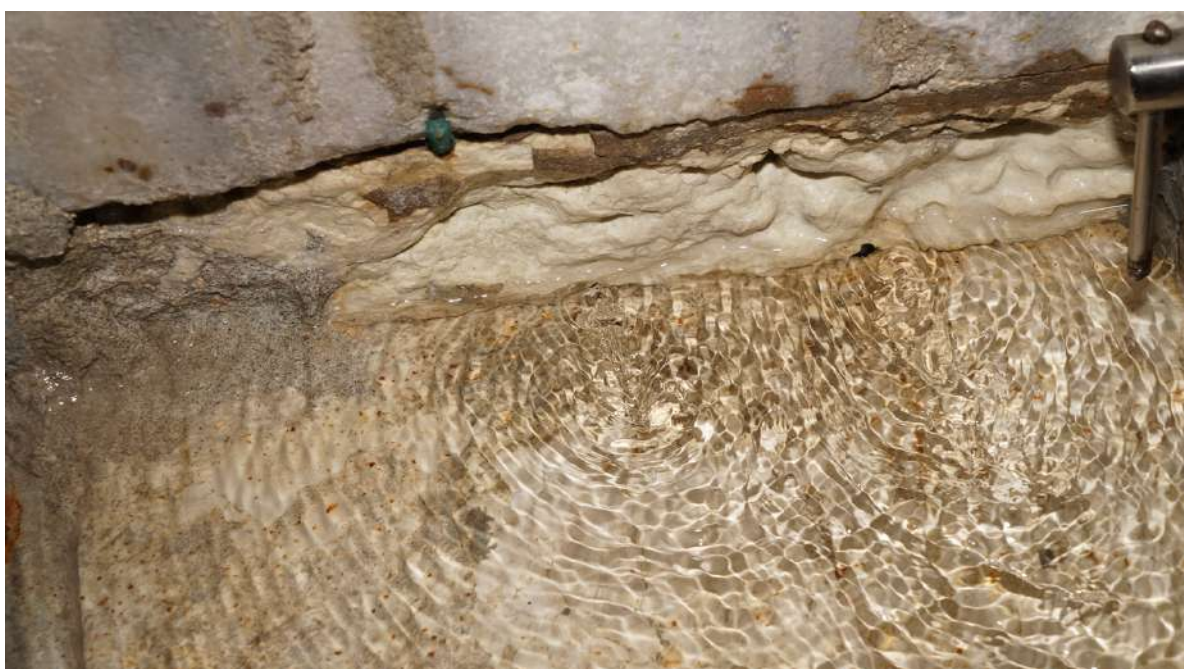
Figura 3– Infiltrazioni d'acqua dal sottosuolo pavimentale.
