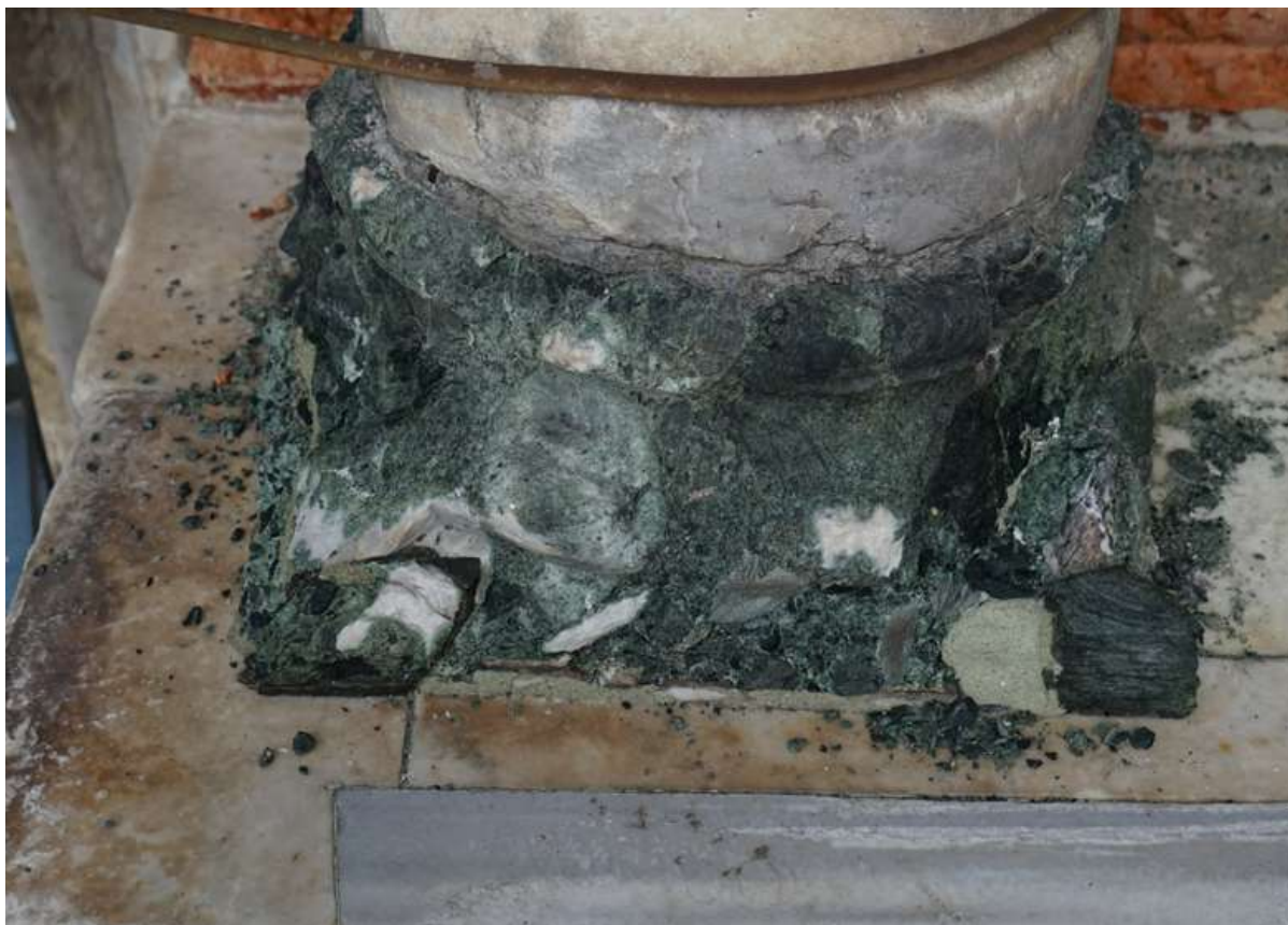
Figura 6 – Il degrado subito da una base di colonna di Marmo Verde Antico (Tessaglia Grecia).
