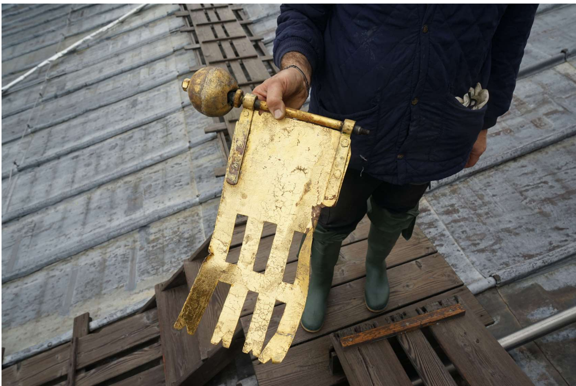
Figura 26 – Tetto della chiesa prospetto ovest. Banderuola dorata strappata dal vento.
