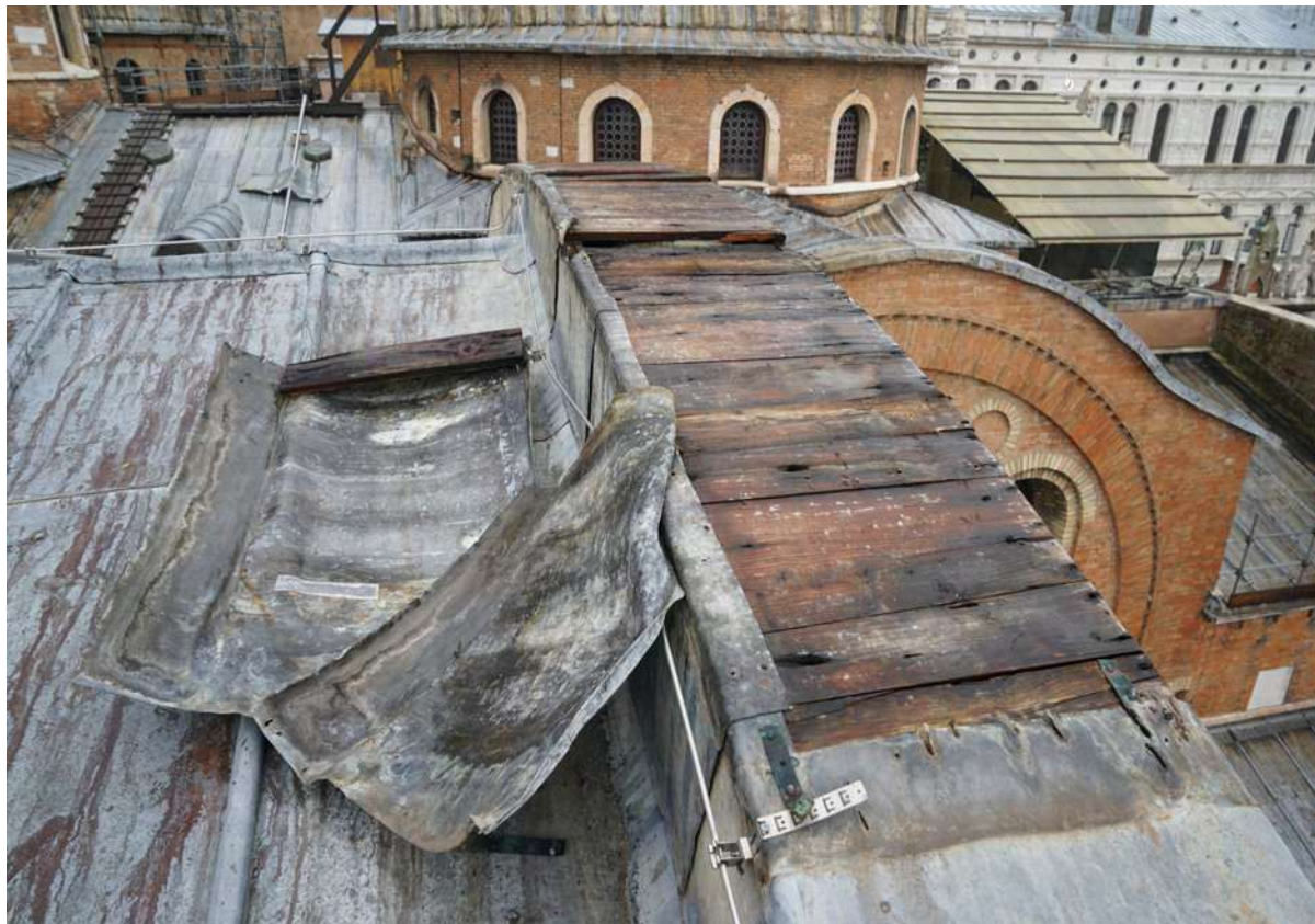
Figura 2 – Lastre plumbee divelte dalla copertura.
