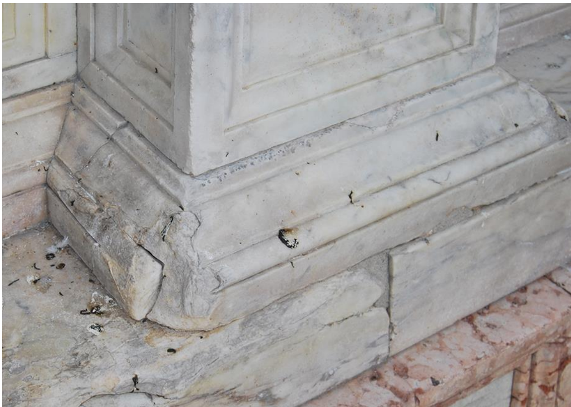
Figura 28 – Il degrado di un basamento di colonna rinascimentale.
