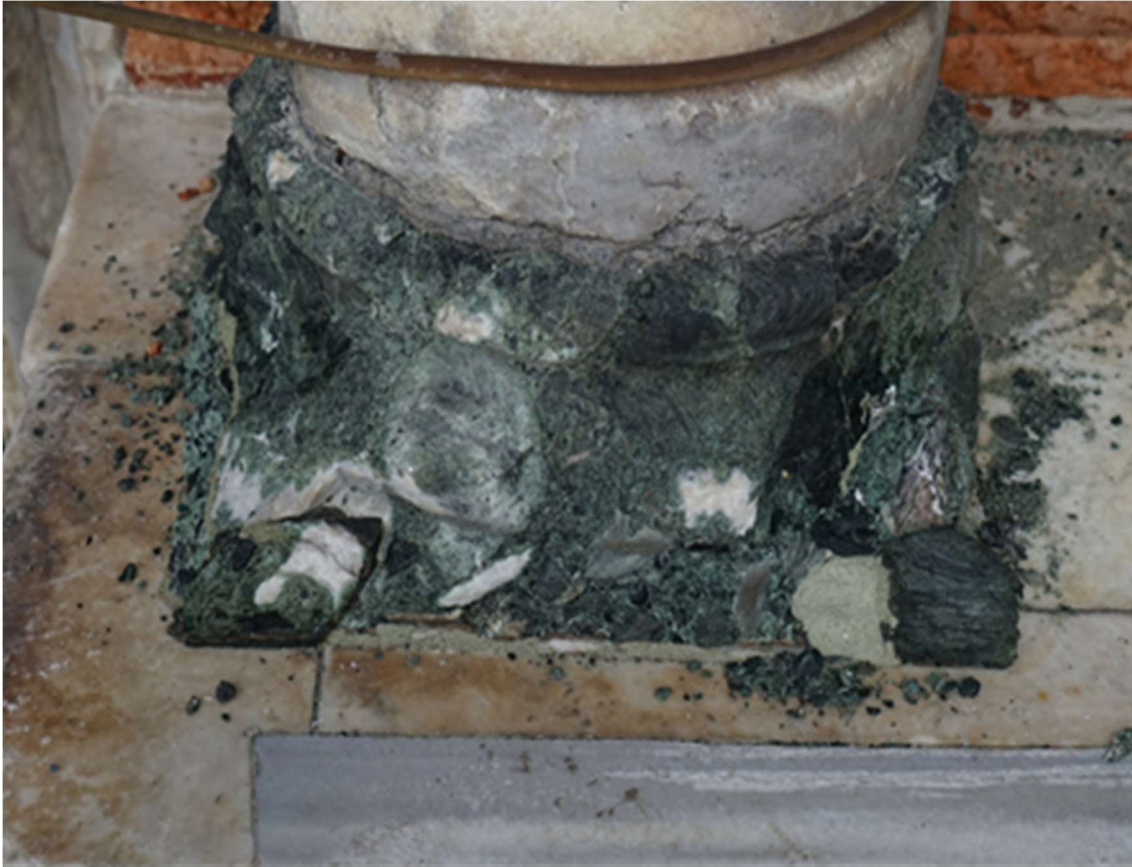
Figura 6 – Prospetto ovest. La disgregazione di una base di colonna di Verde Antico.
