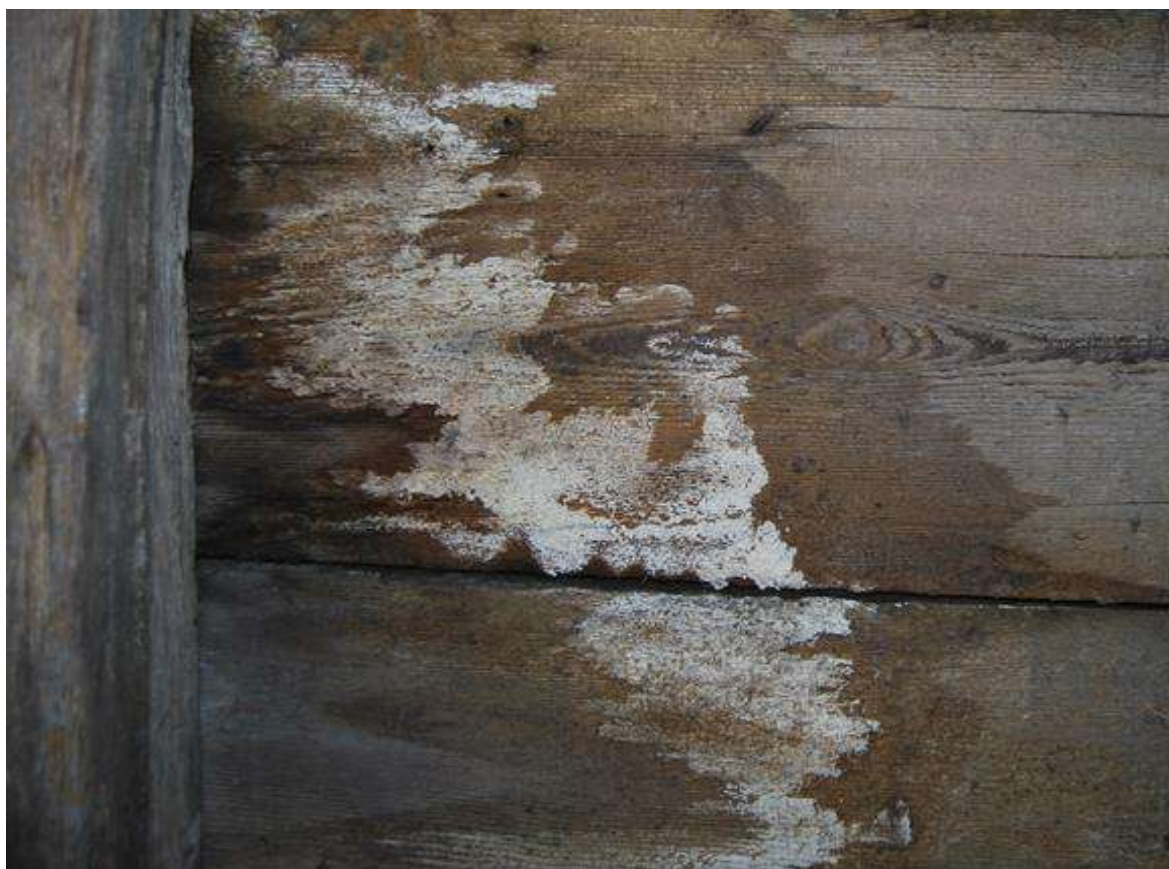
Figura 4 – Lo stato di degrado delle costolature e del tavolato.
