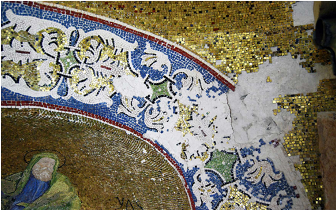
Figura 19 – Nartece. Cadute di superfici a mosaico della Tomba Failer.
