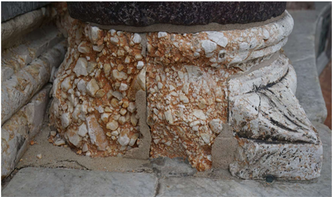
Figura 5 – Prospetto ovest. La disgregazione di una base di colonna di Pomarolo d'Arbe.
