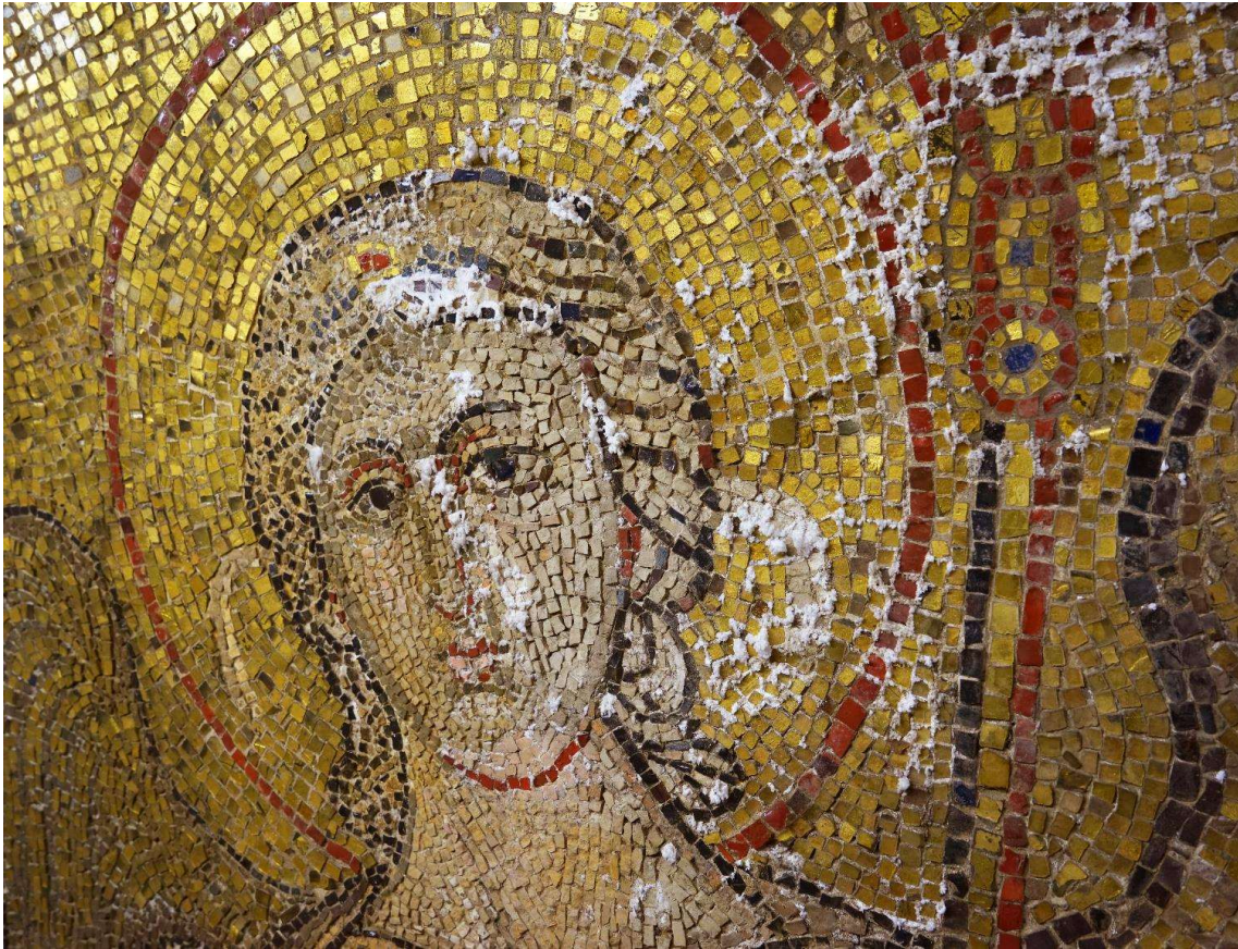
Figura 4 – Le efflorescenze saline su un tratto di mosaico, dovute alla risalita capillare
