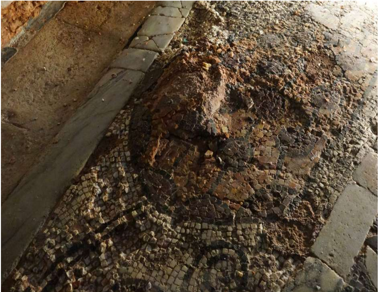
Figura 3 – Lo stato di degrado di un tratto della coda di un pavone
