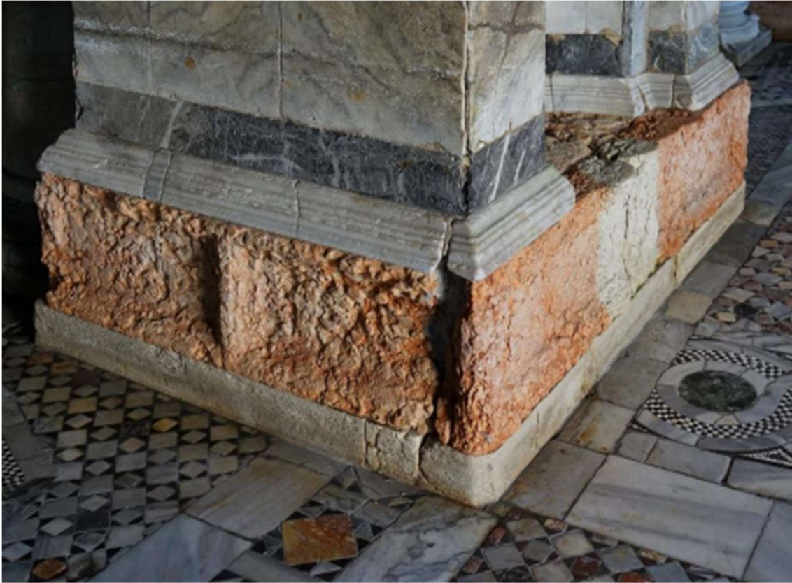
Figura 8 – Nartece. Il degrado di una base di pilastro in marmo rosso di Verona
