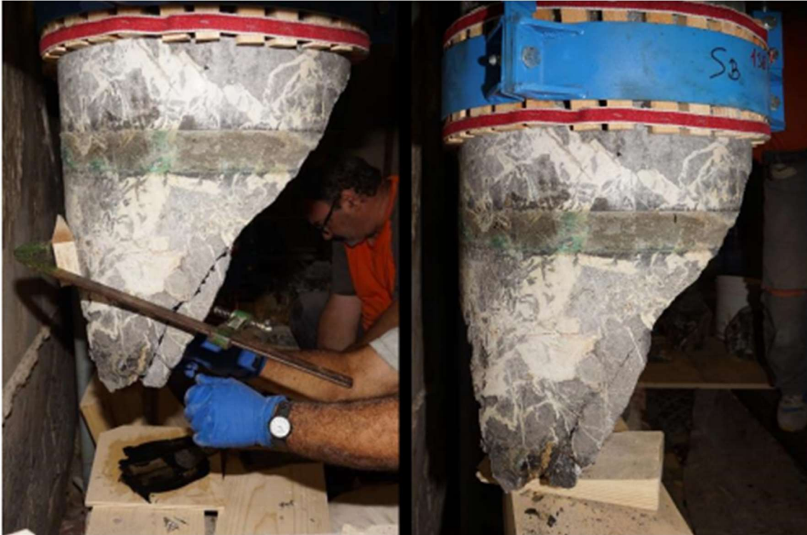
Figura 23 – Nartece. Prime fasi del consolidamento di uno dei quattro fusti di colonna.
