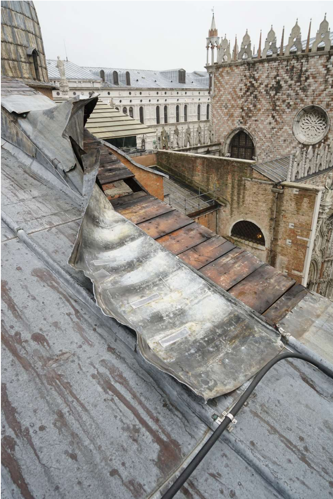
Figura 26 – Tetto della chiesa prossimo al prospetto sud. Lastre di piombo strappate dal vento.
