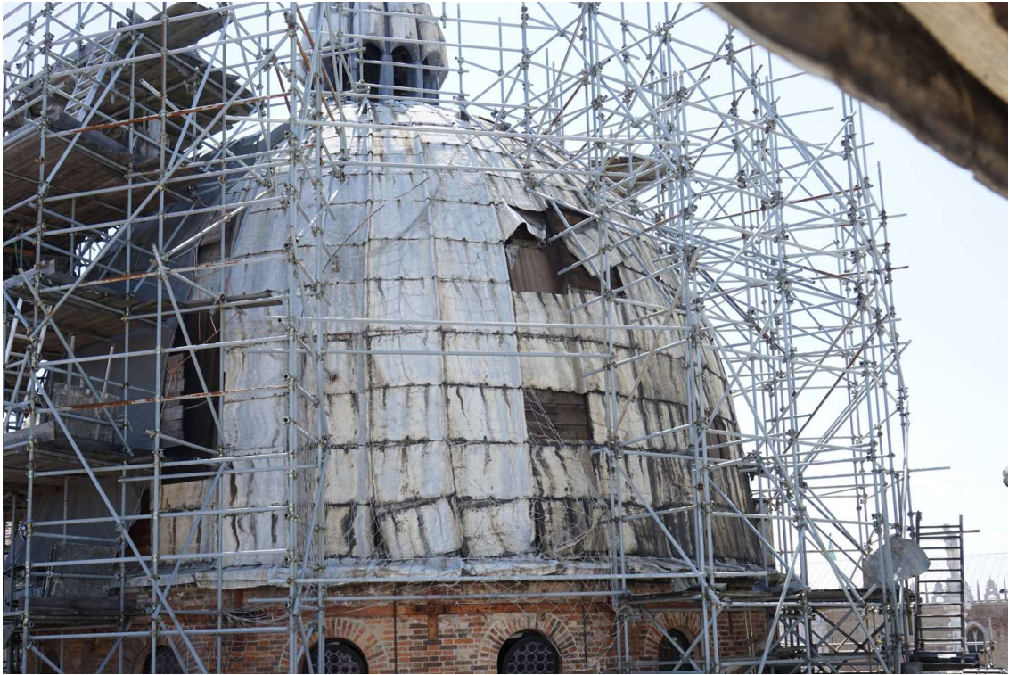
Figura 25 – Cupola del Coro. Lastre di piombo strappate dal vento il 12 novembre 2019.
