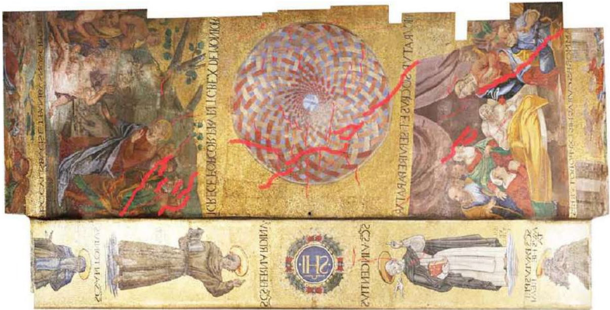
Figura 1 – Rilievo al laser-scanner e fotoraddrizzamento del mosaico presente sull'intradosso dell'arcone contiguo alla testata del transetto destro, con evidenziate le principali lesioni che percorrono le sue superfici.
