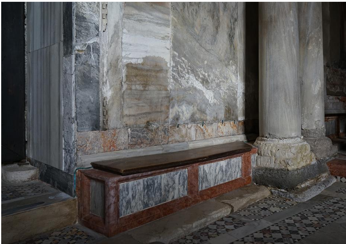
Figura 24 – Il degrado del rivestimento marmoreo.
