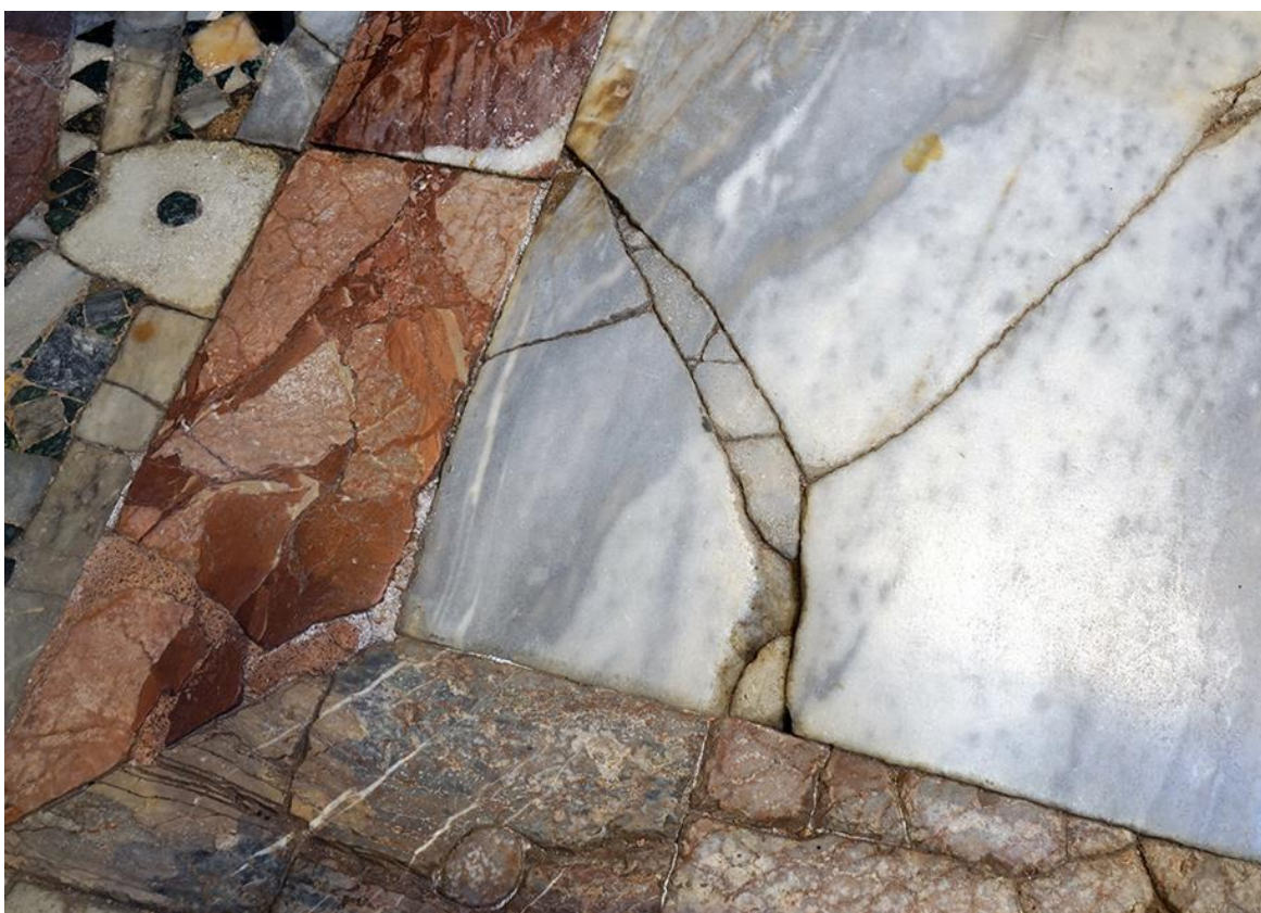
Figura 34 – Il degrado di un tratto di pavimentazione.
