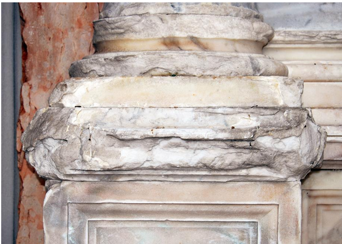
Figura 29 – Il degrado di una base di colonna.
