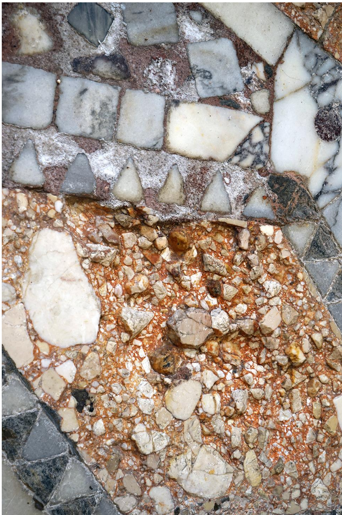
Figura 35 – Il degrado di un tratto di pavimentazione.
