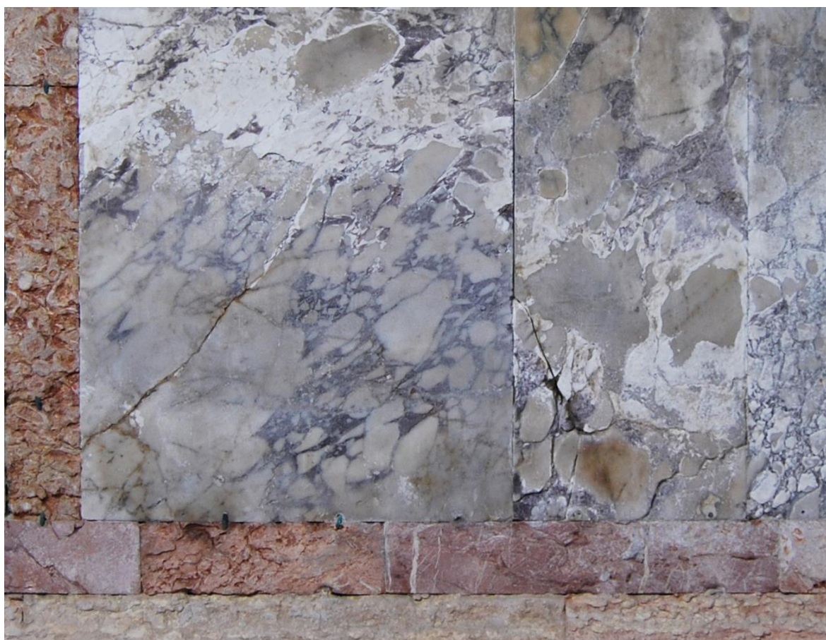
Figura 22 – Lo stato di degrado delle lastre marmoree sottostanti il trittico.
