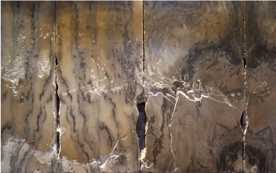
Figura 12 – Interno della Basilica. Il degrado di un tratto dei rivestimenti marmorei di Pavonazzetto toscano
