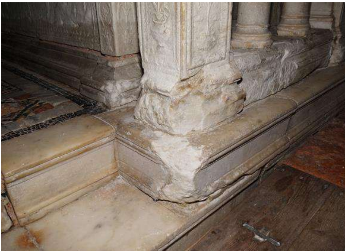
Figura 6 – Le condizioni conservative di una base delle 'alette' e dei gradini.
