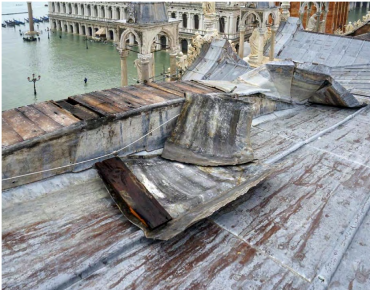
Figura 1 –Lastre plumbee del tetto sollevate (in secondo piano) o strappate dal maltempo del 12 novembre 2019. In primo piano una lastra, rovesciata, che ha trascinato con sé un tratto del tavolato sottostante.
