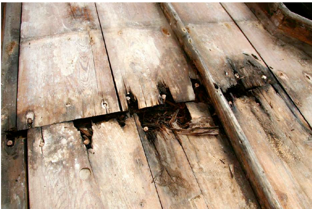
Figura 6 – La marcescenza di un tratto di tavolato ligneo sottostante le lastre plumbee.
