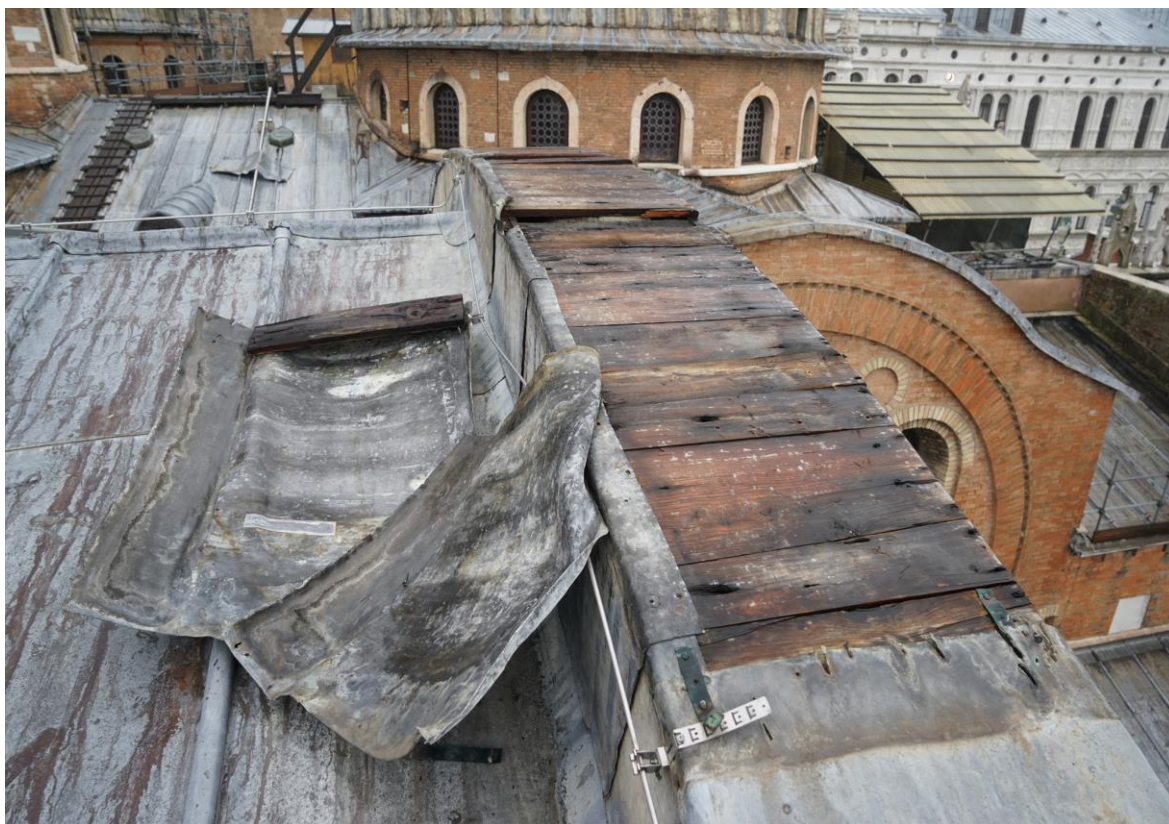
Figura 42 – Lastre plumbee divelte dal vento.
